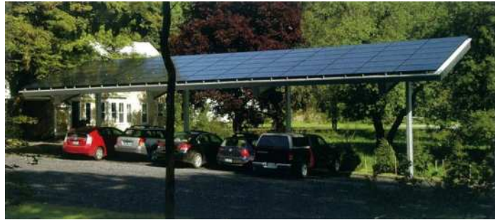
<그림 6-43> 음영지역에 설치된 태양광발전패널
