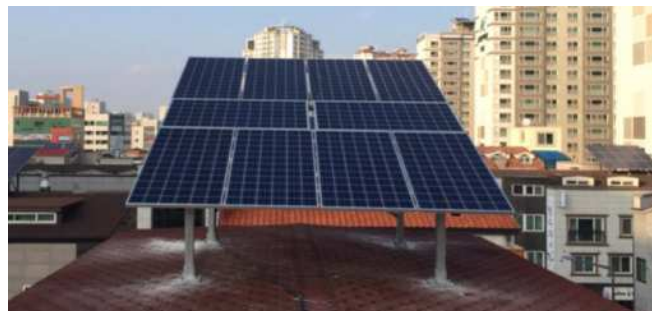
<그림 6-44> 지붕 설치의 잘못된 예
